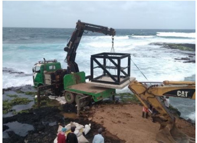
Installation der Wasserpumpen für die Garnelen-Farm auf São Vicente durch die lokale Vereinigung Fazenda de Camarão (Januar 2018)
