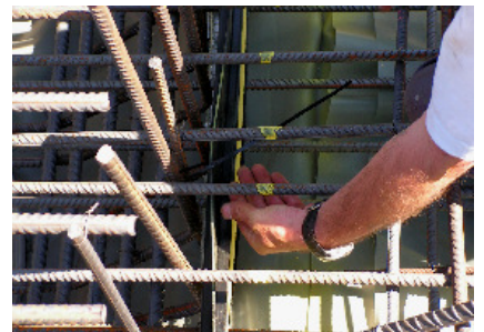
Injektionsprofil im Bereich Pumpensumpf
