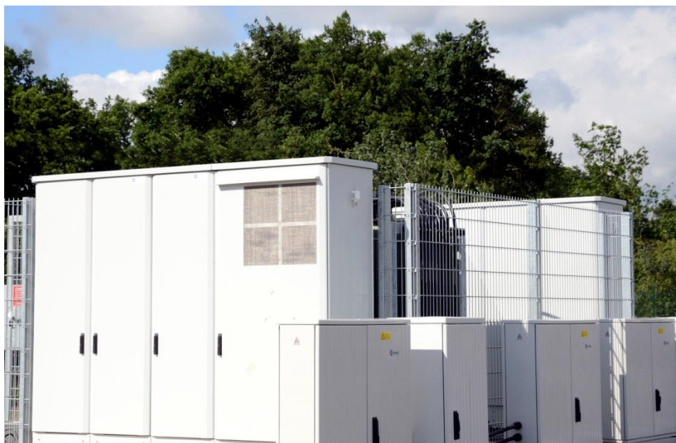
Bildunterschrift: weltweit erstes Solarkraftwerk mit 1500 Volt DC-Spannung
